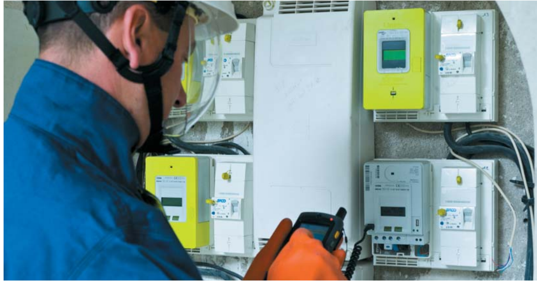
Déploiement des compteurs Linky
